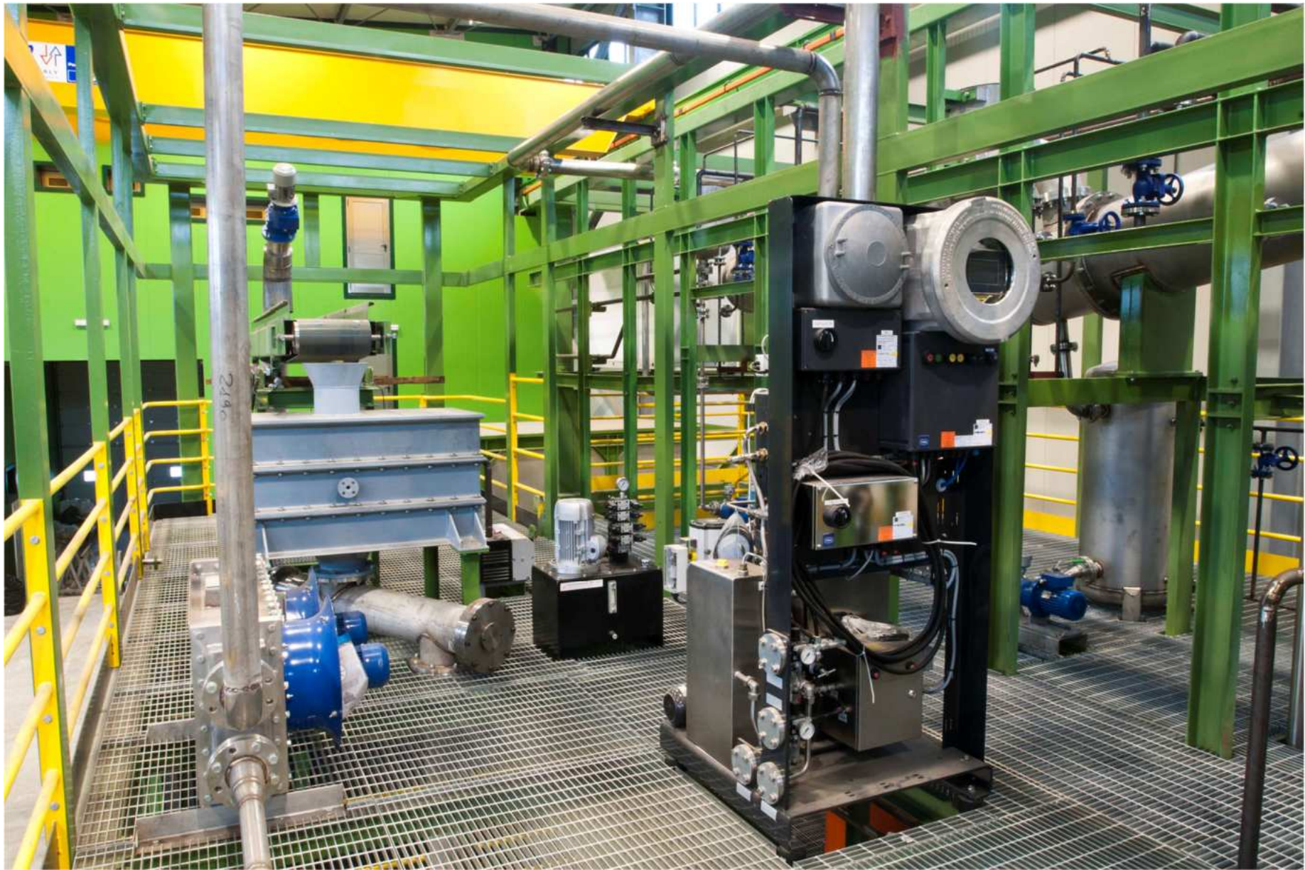
NASTRO PESA-PRIMO ISOLATORE-POMPA VUOTO
