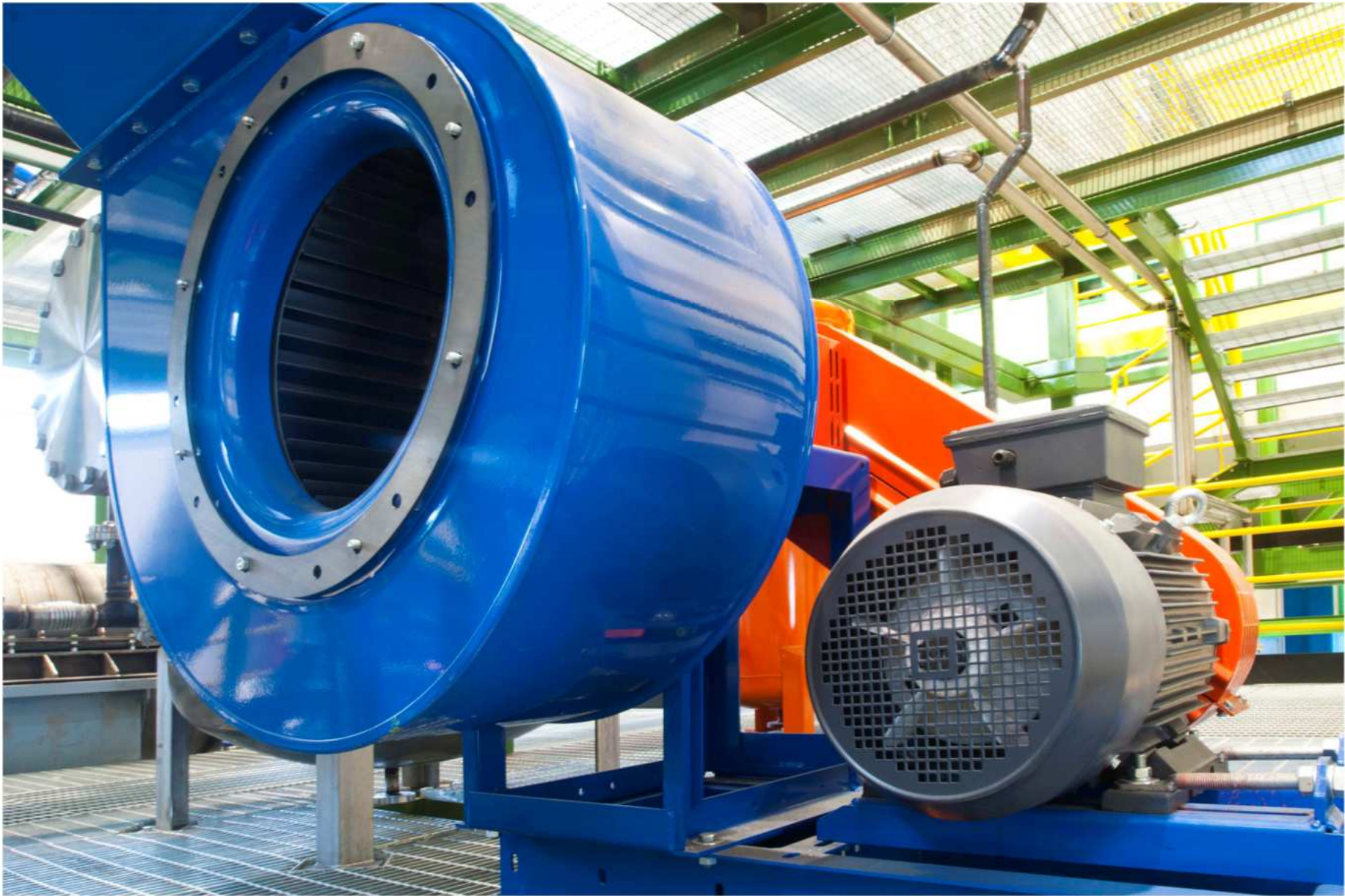
VENTILATORE RAFFREDDAMENTO OLIO
